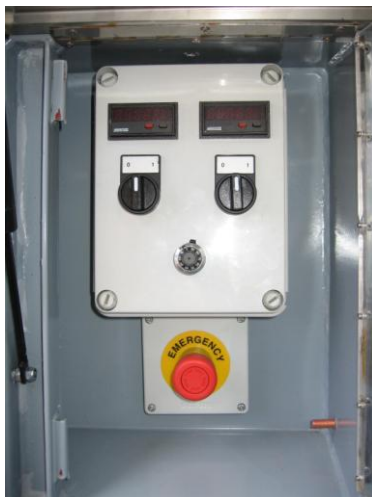
Utvendig skap for styring av frekvensomformere
